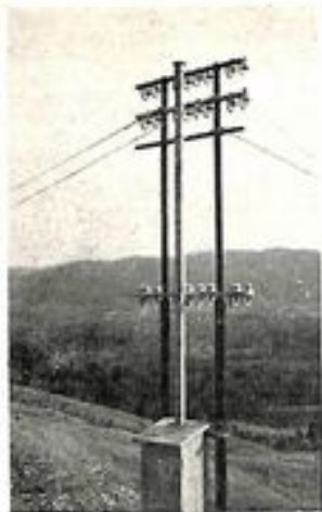
Kabel-opstijpnaal in de telefoonroute Hollandia-Hollandiahaven.
