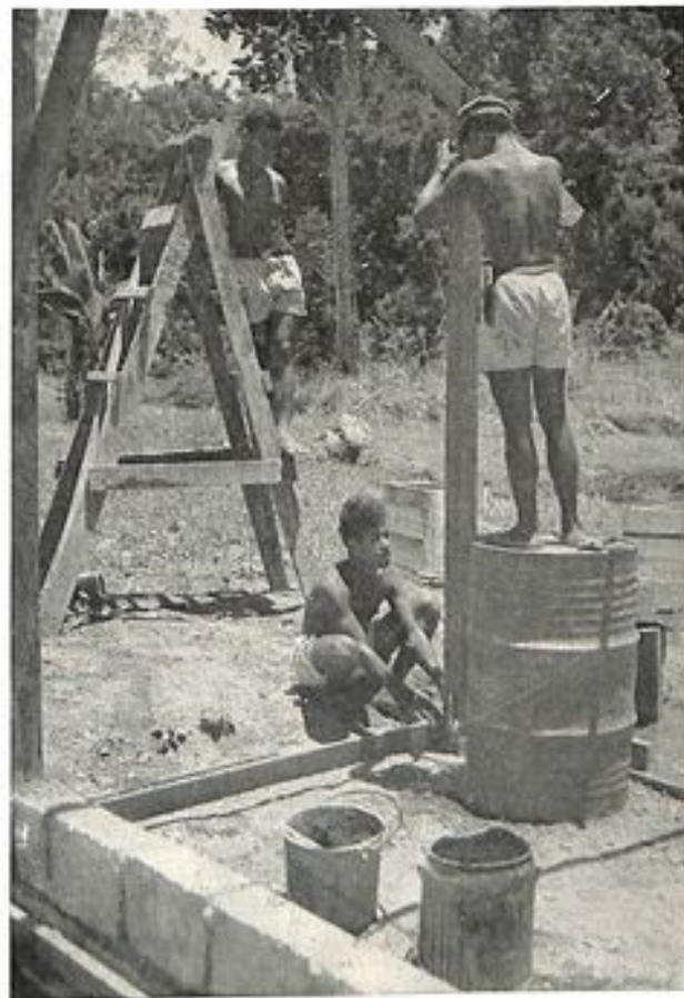
Het „te lood zetten“ van de stijlen met een schietlood. Alles wordt vaktechnisch uitgevoerd.
